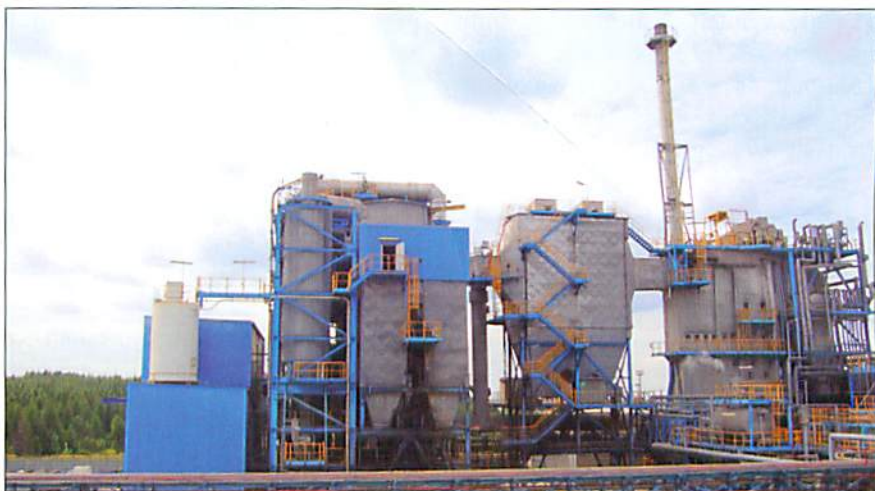
Fragment instalacji oczyszczania gazów wylotowych
