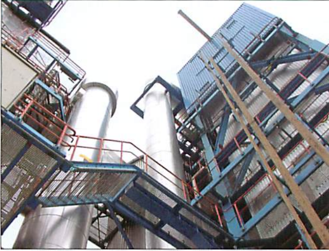
Instalacja SARPI Dąbrowa Górnicza spełnia najbardziej rygorystyczne wymogi stawiane spalarniom w zakresie ochrony środowiska
