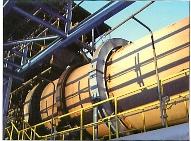
Piec obrotowy jest głównym agregatem spalania odpadów stałych, półpłynnych, ciekłych i gazowych
